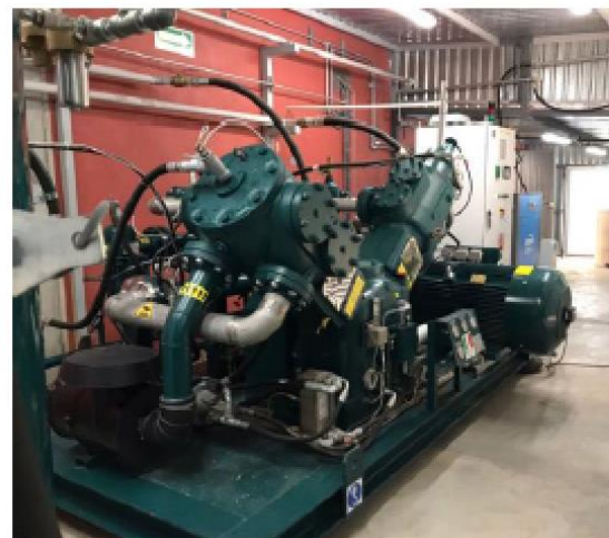
Compresor de Alta
