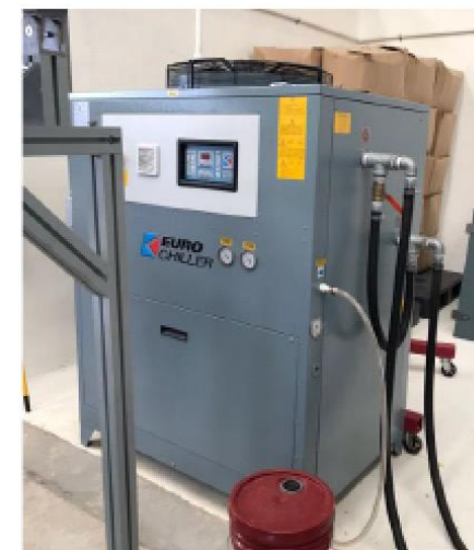
Chiller de enfriamiento
